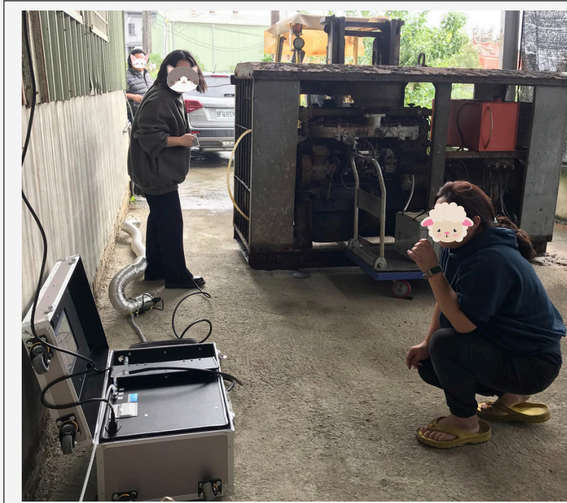
⌘ 連接發電機實測
